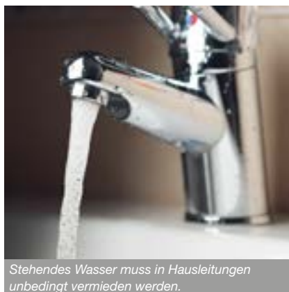
Die unsichtbare Gefahr: Legionellen im Trinkwasser. Temperaturen zwischen 25 und 55° C in Hausleitungen fördern das Wachstum von Bakterien und Keimen.
