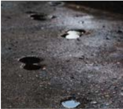
Stehendes Wasser muss in Hausleitungen unbedingt vermieden werden.
